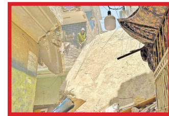
گروه حوادث/ ابریش ساختمان در حال احداث در شهر جویبار منجر به مرگ دو کارگر شد. رضا قلاچ، مدیرعامل جمعیت هلال احمر استان کرمان گفت:
