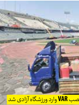
تجهیزات مخصوص نصب VAR وارد ورزشگاه آزادی شد
