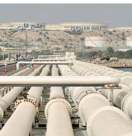
نمای کلی از خط تولید نفت در منطقه پارس جنوبی، جنوب ایران
