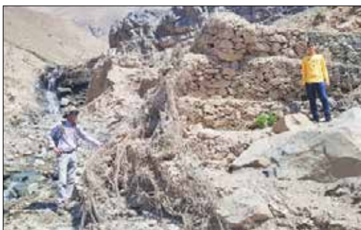
تخریب بند گابیونی آبخیزداری در ۱۴۱۳ متری دهانه تونل / عکس (۳)
