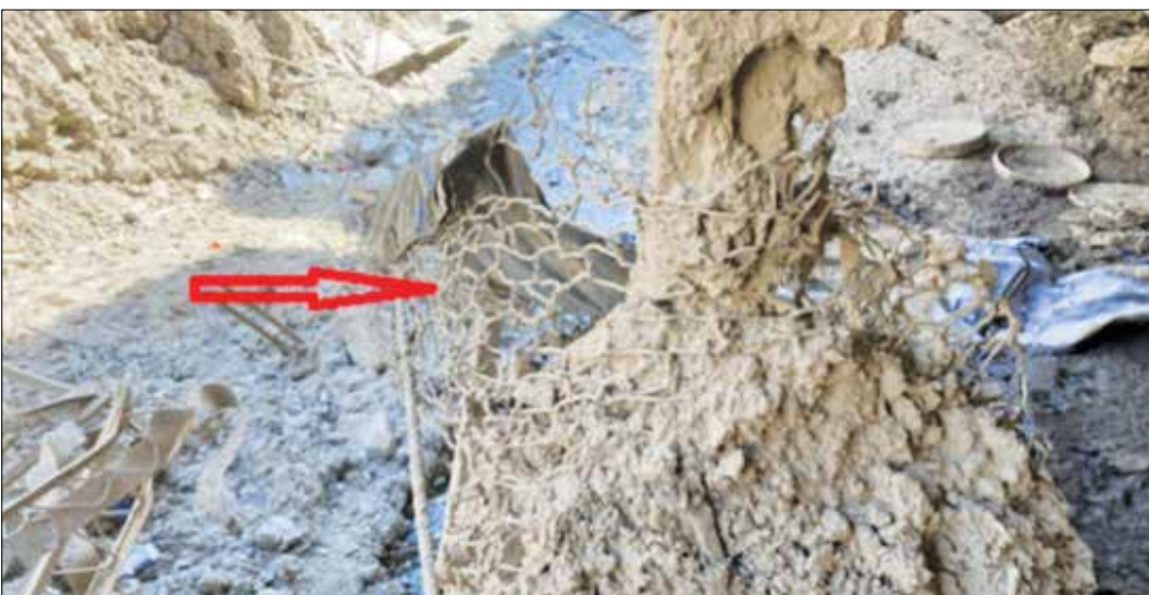
بقایای تورهای فلزی گابیون‌های آبخیزداری در سازه‌های تخریب شده و داخل تونل امامزاده داوود / عکس (۴)
