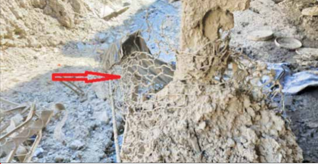
بقایای تورهای فلزی گابیون‌های آبخیزداری در سازه‌های تخریب شده و داخل تونل امامزاده داوود / عکس (۴)
