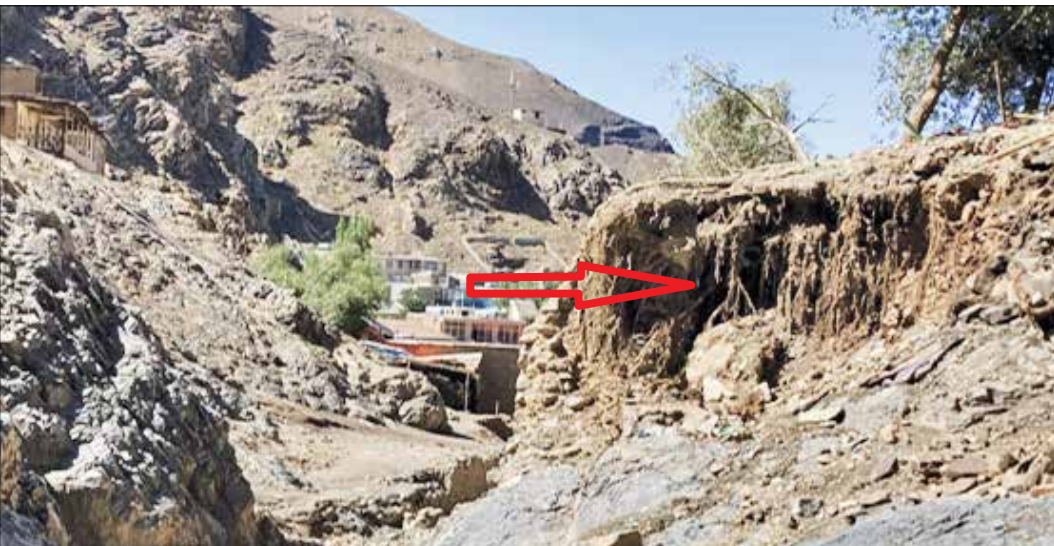
تخریب دیواره کانال قبل از ورود آب به تونل / عکس (۱)
