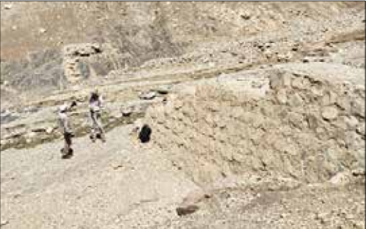
تخریب سد سنگی-ملاتی آبخیزداری در ۱۰۶۲ متری دهانه تونل / عکس (۲)
