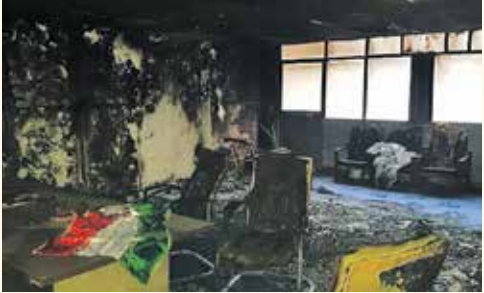
تخریب خانه خیر؟
